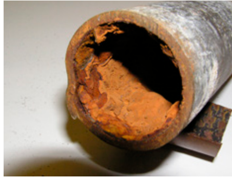
Korroosiolle altistunut putki.
