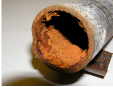
Korroosiolle altistunut putki.
